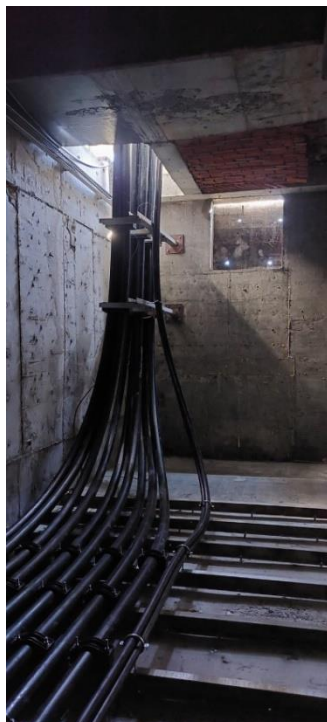
Slika 2b. Postojeći vertikalni šaht uz plato TS Bor 5
